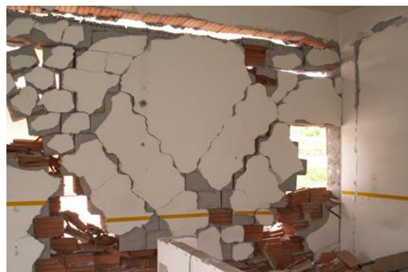
In einem durch das Erdbeben am 29.10.2002 zerstörten Wohnhaus
